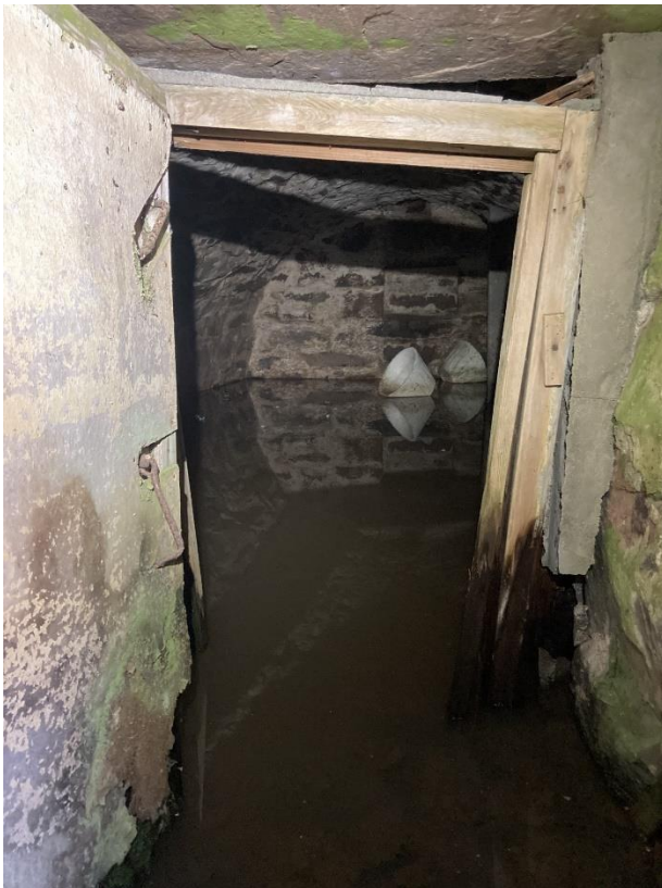
Vattenfylld källare till stolpboden.
